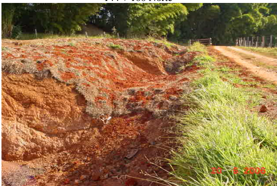
Figura 13: Três das oito bacias de contenção dispostas em série, após escada hidráulica na SP 127 km 127 + 200 m
