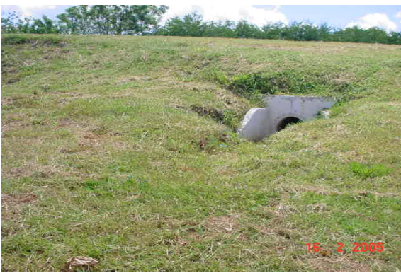
Figura 3: Saída de águas de rodovia concentrando em único ponto SP 127 km 144 + 100 m - Norte.
