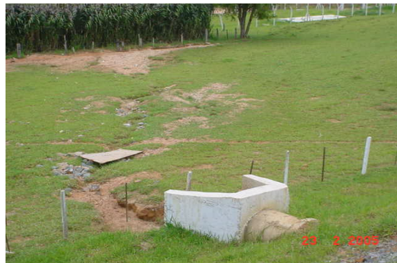
Figura 6: Danos decorrentes da descarga anterior.
