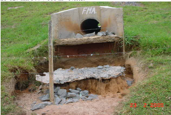
Figura 5: Saída e pedras para dissipar energia mal dimensionada SP 127 km 189 + 100 m - Sul.
