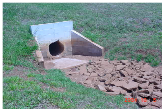
Figura 8: Saída d'água e dissipador de energia, com rachão, em local próximo ao anterior.
