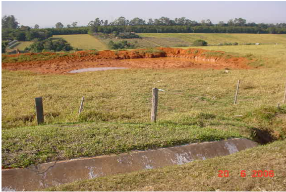
Figura 11: Bacia de contenção de grande porte na SP 127 km 144 + 100 Norte
