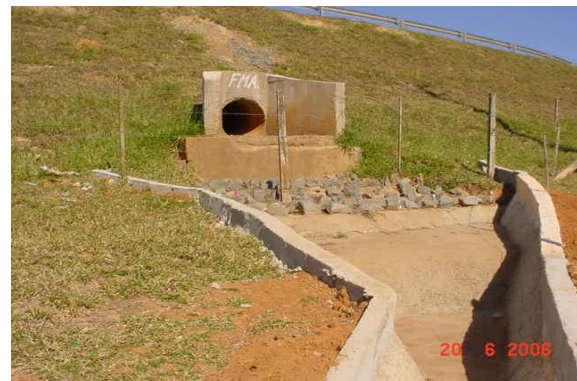
Figura 14: Dissipador de energia seguido de condutor revestido de concreto, na SP 127 km 189 + 100 m
