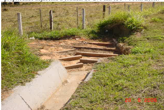
Figura 9: Dissipador de energia, com obstáculos alternados, na SP 127 km 172 + 250m
